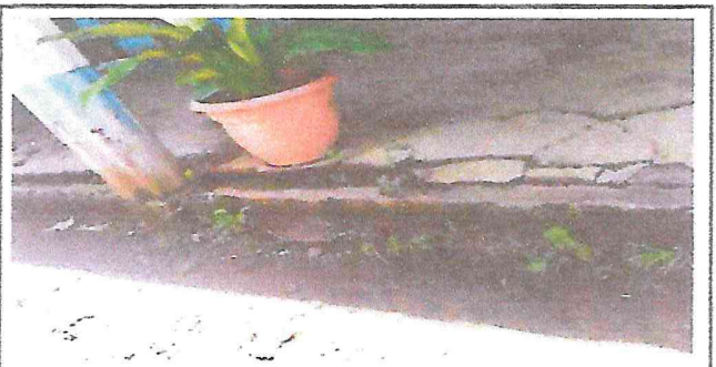
Foto 6: Banqueta en mal estado
