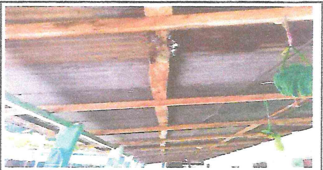
Foto 4: Lamina en mal estado
