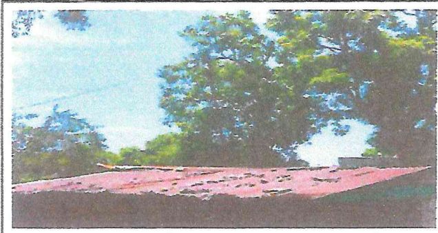
Foto 1: Lamina en mal estado
